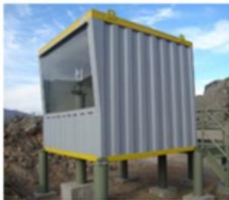
Hình 1. Trạm máy chủ (Base).
