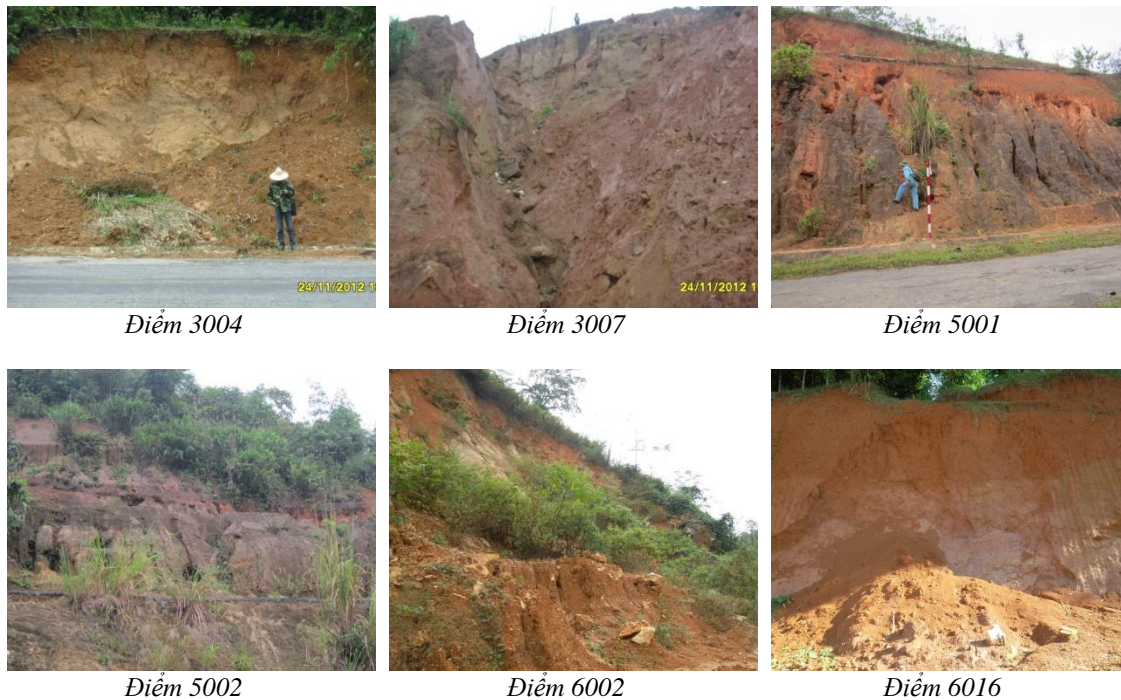
Hình 2. Một số hình ảnh trượt lở tại huyện Quế Phong
