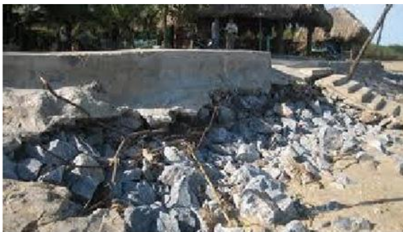
Hình 4. Đê biển xã Quảng Cư (Sầm Sơn) bị phá hủy sau bão
